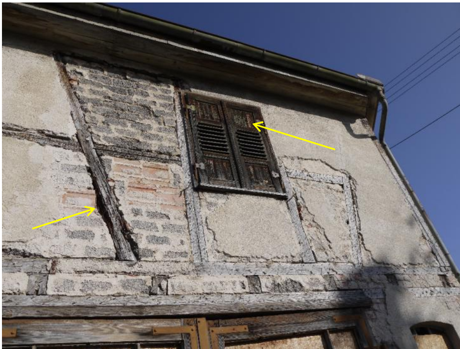
Abb. 8: Spalten am Mauerwerk und potenzieller Hangplatz hinter Fensterladen
