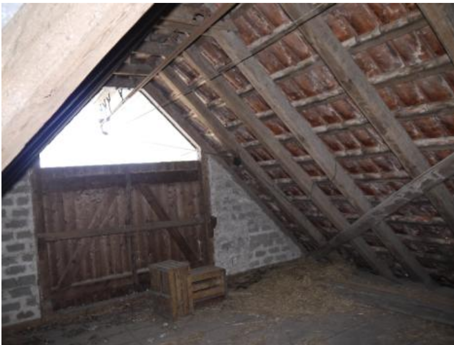
Abb. 7: Große Öffnung am Giebel mit etwas Vogelkot am Boden dahinter
