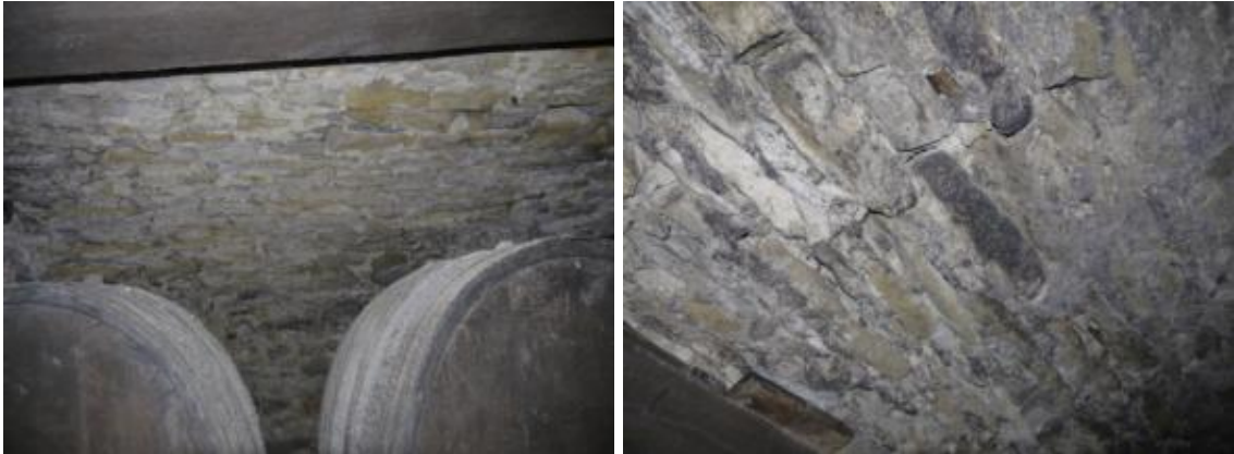
Abb. 9: Gewölbekeller mit tiefen Spalten zwischen den Steinen.
